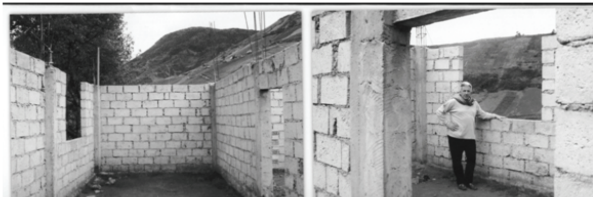
Alcuni particolari della scuola ristrutturata in Ecuador dall'Associazione prima dell'inizio dei lavori
